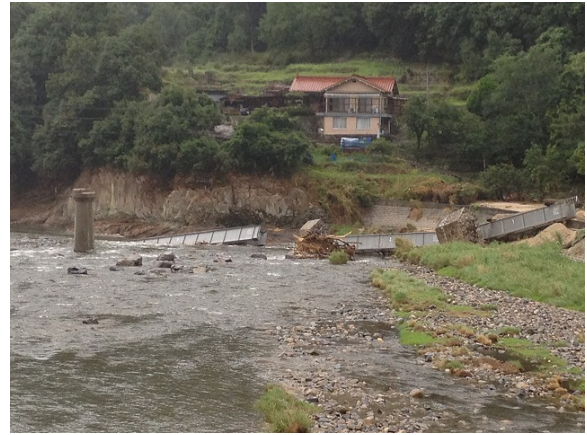
図2：三篠川第一橋梁の被災
