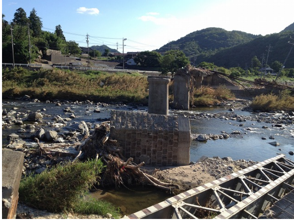
図1：三篠川第一橋梁の被災
